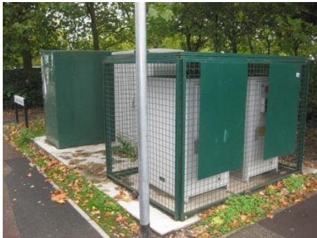
地上シス テム全景
