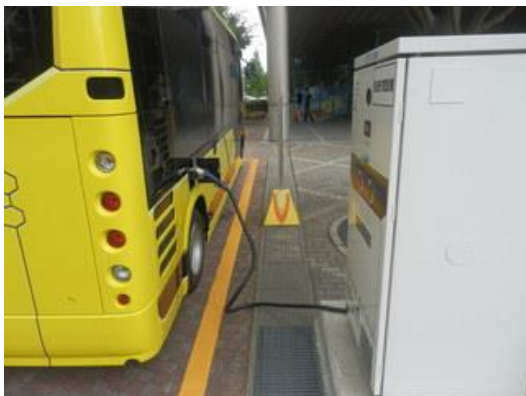
宇宙ばす CHAdeMO 50kW ターミナル(2か所)
