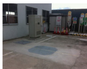
長電バス営業所の充電設備
