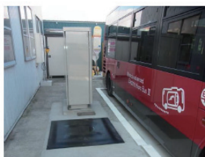
充電電源盤とWEB-3
