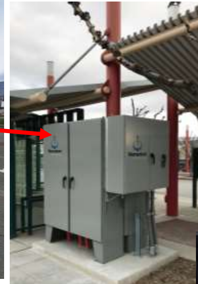
高周波電源の 設置状況
