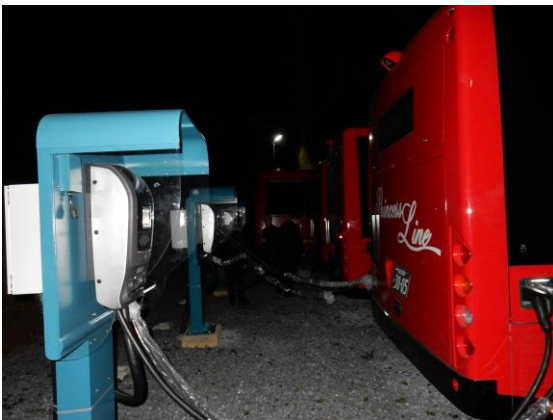
京都急行バス BYD急速充電 20kW×2式 バス充電所(夜間)
